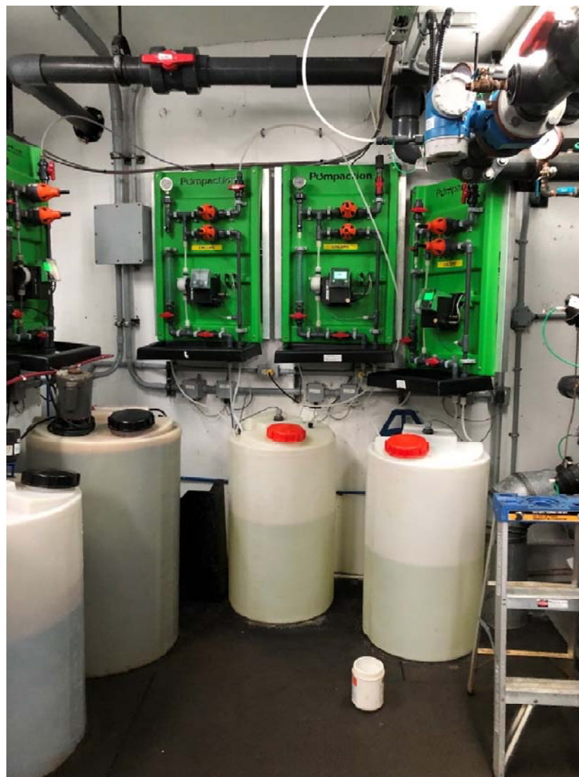
Photo 2 Système de contrôle et de suivi des pompes pour les puits PE-01, PE-02 et PE-03 (18 janvier 2023)
