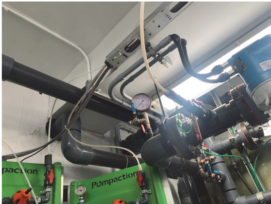
12. Vue de l'injection de chlore, avant l'entrée au réservoir – 2024-05-02
