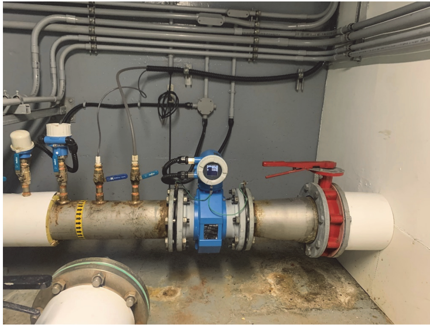
13. Vue du compteur et de la conduite de distribution – 2024-05-02
