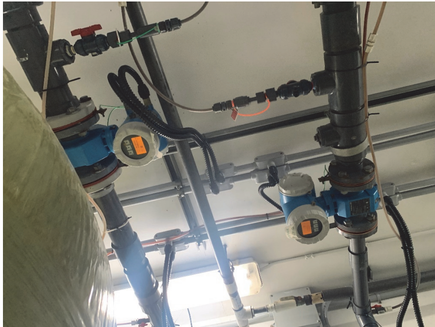
10. Vue des compteurs d'eau des puits PE-01 et PE-02, ainsi que des points d'injection du permanganate de potassium – 2024-05-02
