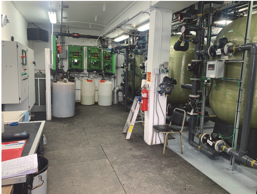
7. Vue intérieure de la station de production – 2024-05-02
