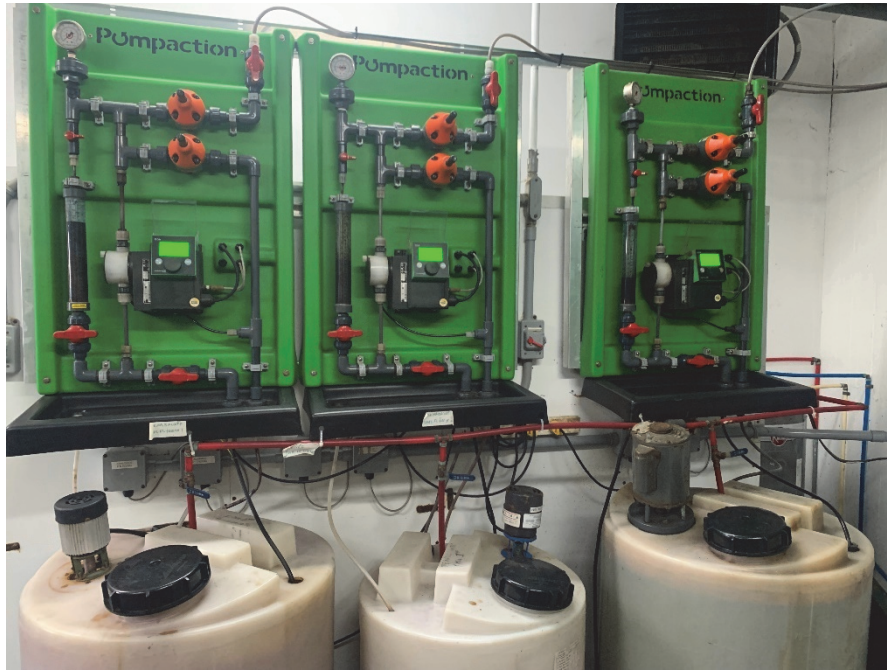
15. Vue de la station de permanganate de potassium- 2024-05-02
