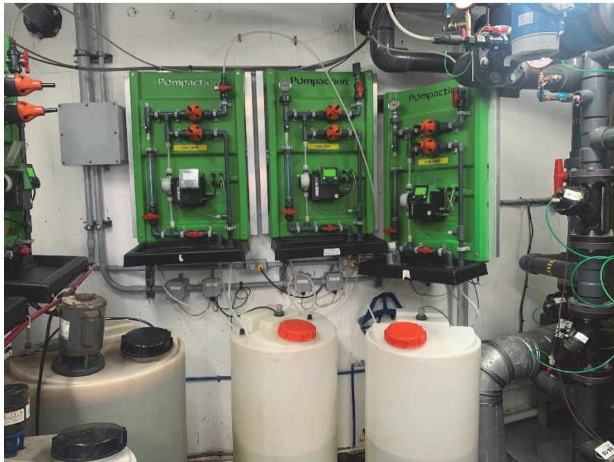
14. Vue de la station de chloration – 2024-05-02
