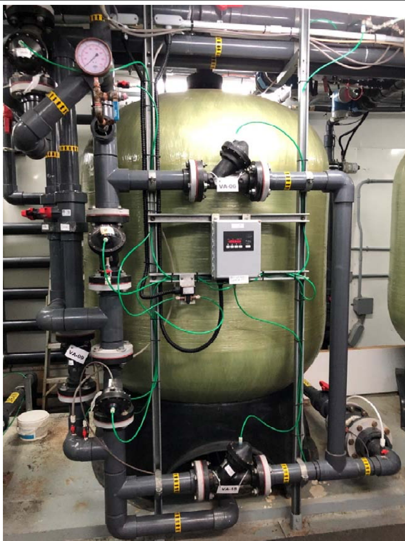
Photo 1 Réservoir de l'une des pompes (18 janvier 2023)
