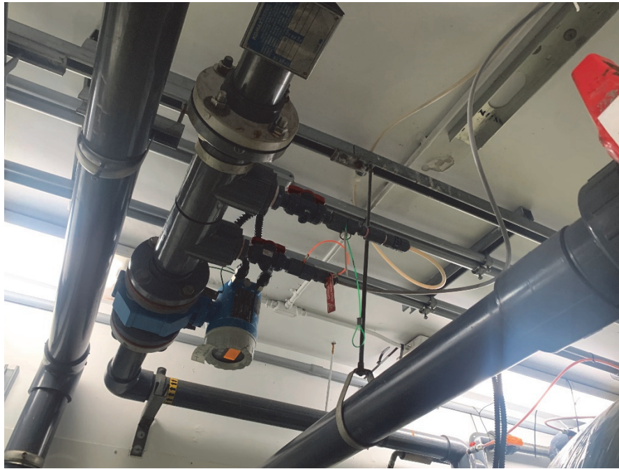
11. Vue du compteur d'eau du puits PE-03, ainsi que des points d'injection du permanganate de potassium et de l'hypochlorite de sodium – 2024-05-02
